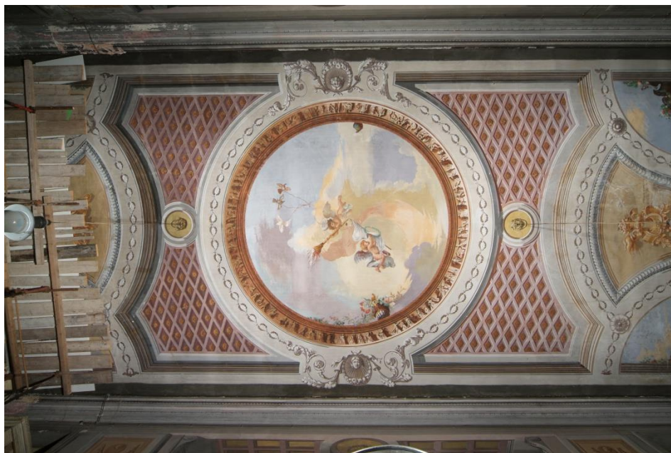
Soffitto salone d'onore prima dell'intervento
