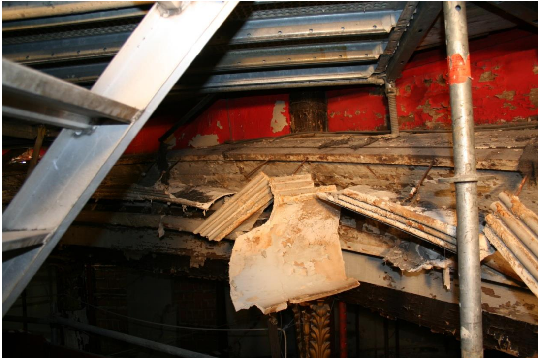
Condizioni del cornicione sommitale prima dell'intervento
